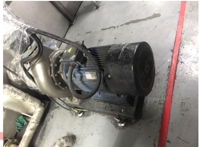
Figure 18: pompe d'eau peinture liquide
