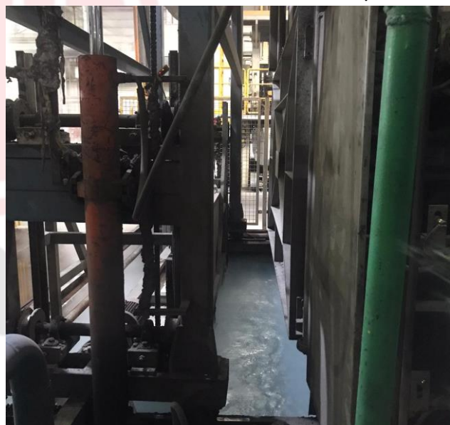
Figure 25 : Bassin de trempe
